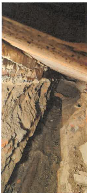
Výkop pod prostorem vstupní chodby – obnažení poškozené / ucpané kanalizační přípojky
